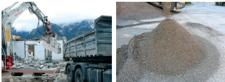
3.14a. ábra Fabeton zsaluzóelemes szerkezetek bontása és az anyagok szét- választása különböző frakciókra, 1-2. fázis
