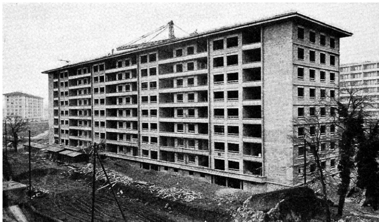
5.1. ábra Kilencszintes szálló épület építése Genfben az 1950-es években, teherhordó Durisol falszerkezettel
