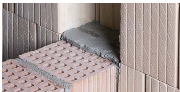
33. Hanggátló fal (25/30 AKU) és LeierPLAN elemekből falazott külső teherhordó fal csatlakozása bekötőszalaggal
